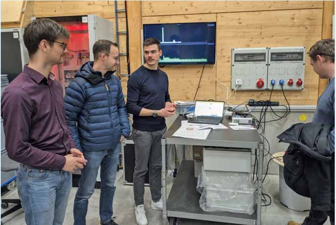
Thomas Haupt (3. v. l.) und Kevin Settler (l.) erklären die Komponenten des Energiemanagementsystems in der Forschungshalle am Campus Feuchtwangen.
