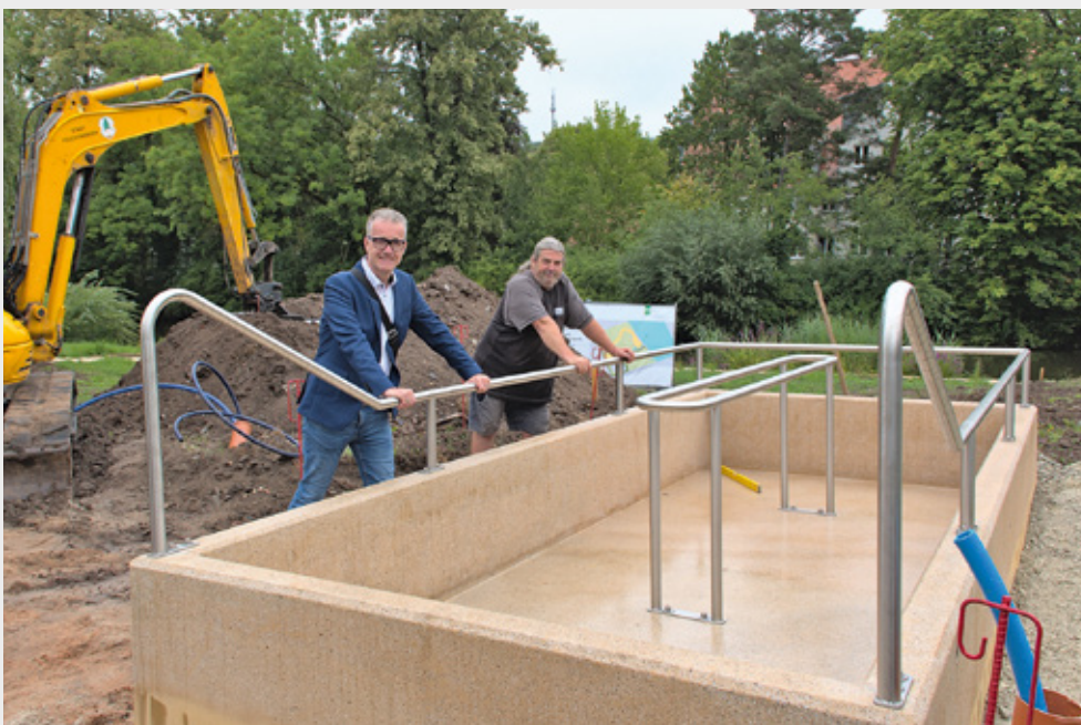
Das große Wassertretbecken für die neue Feuchtwanger Kneipp-Anlage steht bereits und lässt die Vorfreude auf das kleine Naherholungsgebiet bei ersten Bürgermeister Patrick Ruh (links) und Bauhofleiter Werner Tippmann noch weiter steigen.
