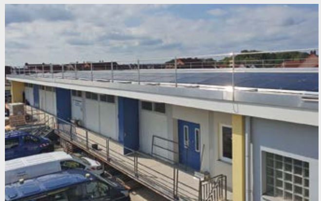
Auf dem Dach der Lagerhalle der Stadtwerke Feuchtwangen ist bereits eine PV-Anlage installiert. Weitere solcher Anlagen mit einer Gesamtleistung von rund 1 MW befinden sich bei den Stadtwerken derzeit in der Umsetzung.
