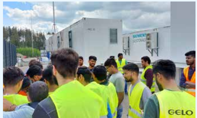
Bayerns leistungstärkster Stromspeicher beeindruckt mit 8.4 MW Leistung und passt dennoch in drei Überseecontainer.
