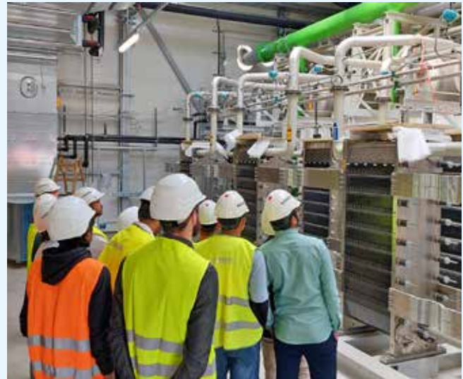
Der Elektrolyseur befindet sich noch im Aufbau – so sind die Komponenten noch gut zu erkennen.
